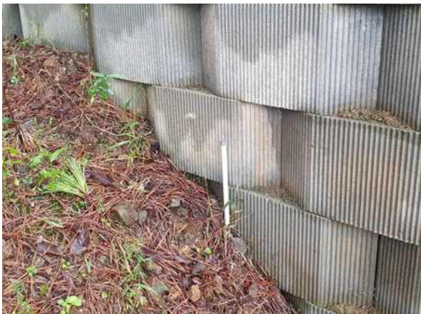
<옹벽 1단 전면 블록 균열>
